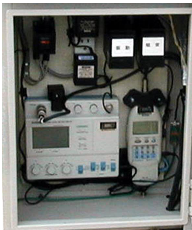
騒音計・振動計収納ボックス内部
